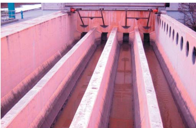
Sandfang in einer Kläranlage
