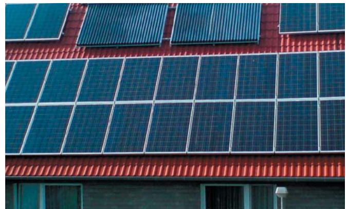
Solarthermie - großes Potential in Österreich
