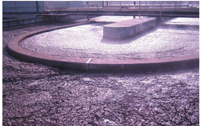
Belebungsbecken einer Kläranlage
