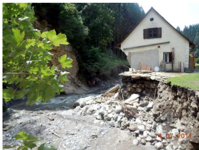
Abb. 4: Hochwasserschaden am Wölzerbach 2011; Wasserwirtschaft Land Steiermark
